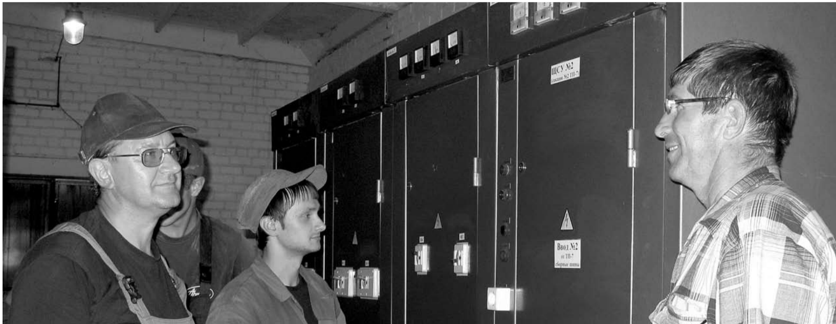
Энергетик участка электрообеспечения Игорь Иванович Супрунов (справа) проводит инструктаж при вводе щитовой в эксплуатацию слесарям-электрикам Сергею Владимировичу Добрикову и Алексею Николаевичу Кобзеву.
